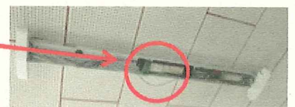
蛍光灯の安定器
